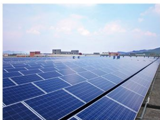
新能源综合自动化系统
